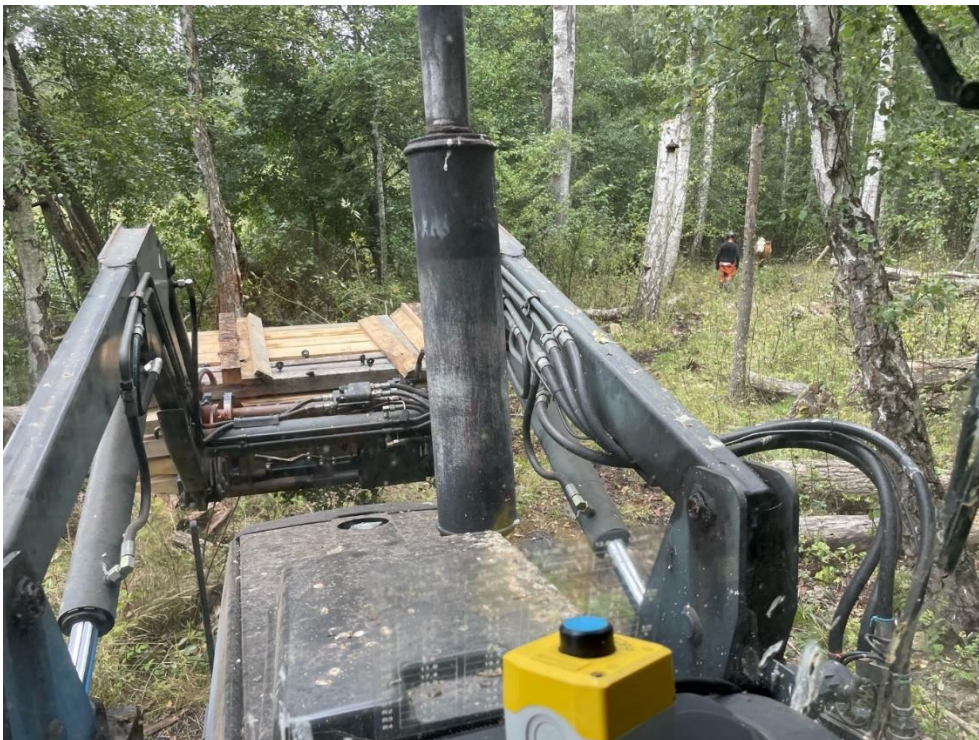
Bild 13. Avlastningen skedde med hjälp av traktor. Nyfikna kossor som nu betar på området följer arbetet. Foto: Rikard Widlund hösten 2023.
