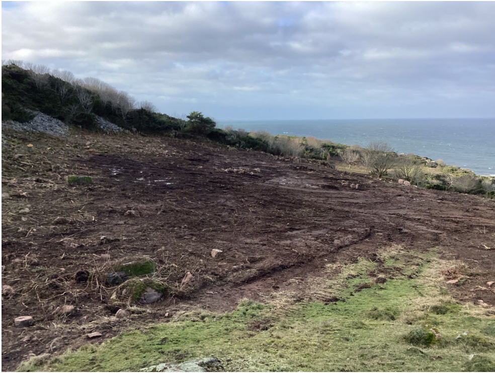
Fotot visar samma område när buskar och träd röjts bort och grävmaskinen har jämnat marken. Foto taget i januari 2023
